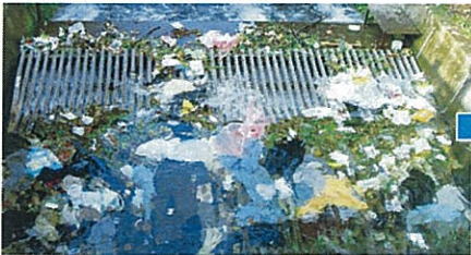
【那須疏水幹線用水路・Vスクリーン】
